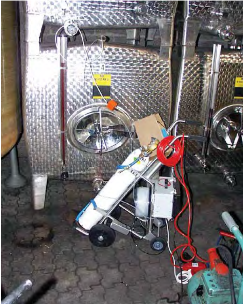
Abbildung 4 Mikro-Oxygenator Compact im Einsatz im Keller
